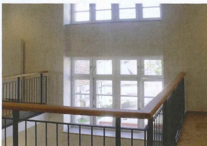
RWA-Fenster mit Kettenantrieb.
